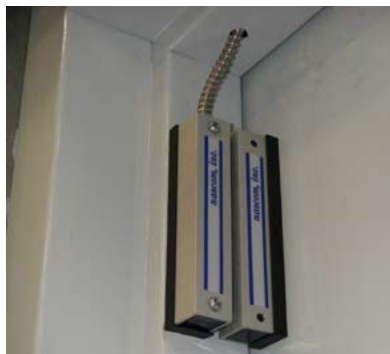
Switch on Door
